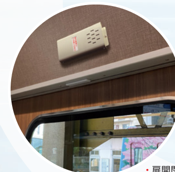
・扉開閉予告灯
