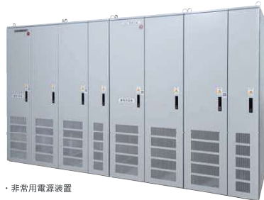
・非常用電源装置
